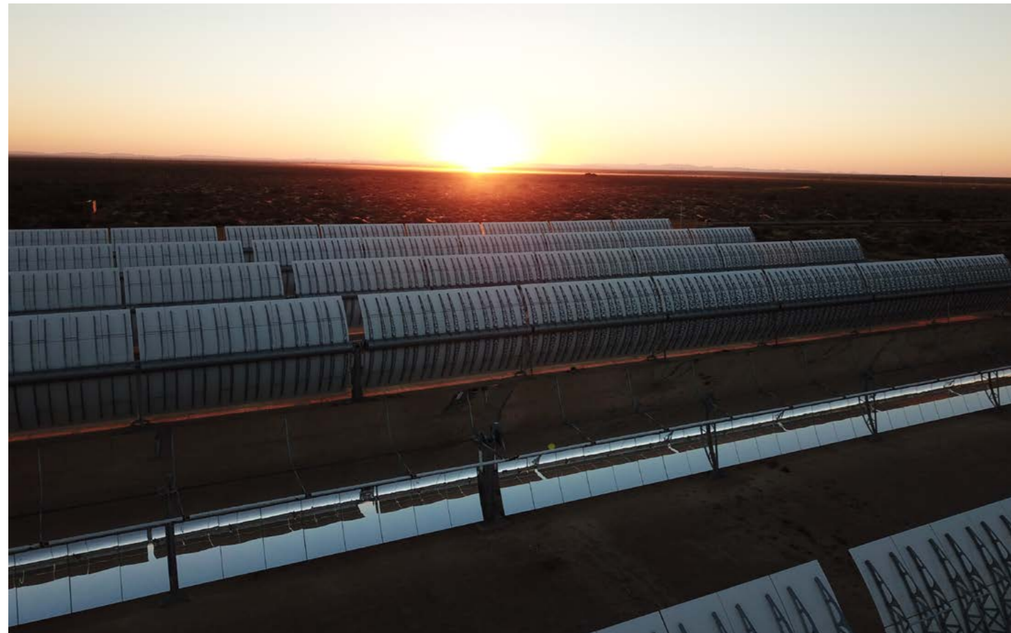
Planta solar termoeléctrica Kathu en Sudáfrica que suministra energía limpia a 179.000 hogares.
